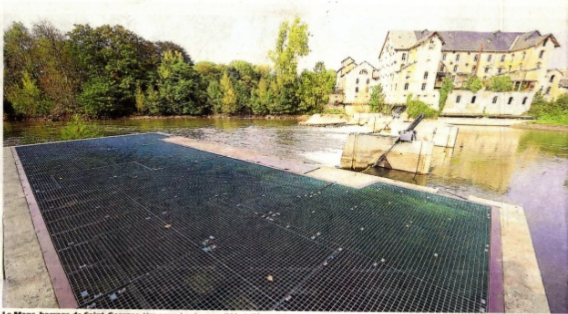
Le Mans, barrage de Saint-Georges. Une passe à poissons a été installée en même temps que les clapets hydrauliques qui régulent le cours de la rivière, notamment pendant les crues. Sept nouvelles passes de ce type devront être réalisées sur ce bassin d'ici 2017. Photo - Le Maine Libre - Denis Lambert.
