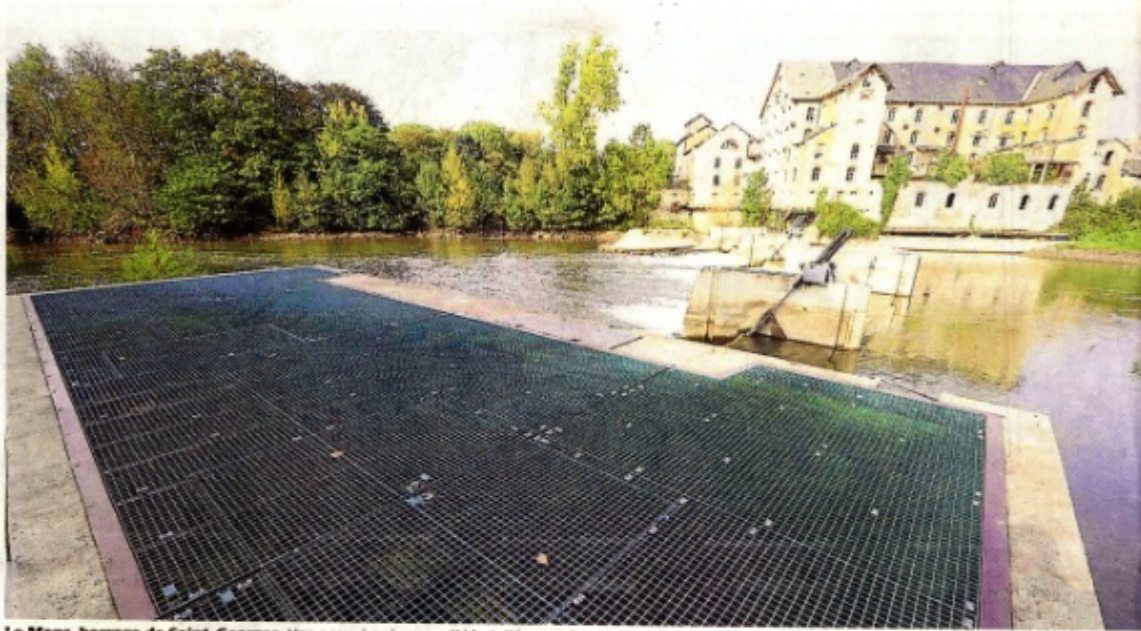
Le Mans, barrage de Saint-Georges. Une passe à poissons a été installée en même temps que les clapets hydrauliques qui régulent le cours de la rivière, notamment pendant les crues. Sept nouvelles passes de ce type devront être réalisées sur ce bassin d'ici 2017. Photo - Le Maine Libre - Denis Lambert.
