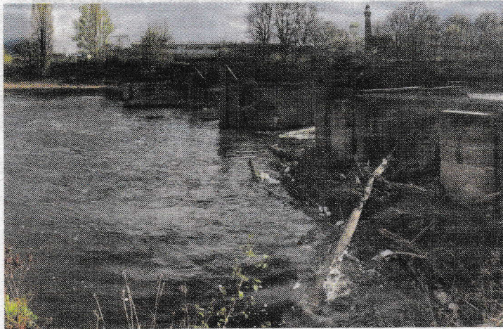
Le barrage n'a toujours pas été restauré. (Photo NR)
